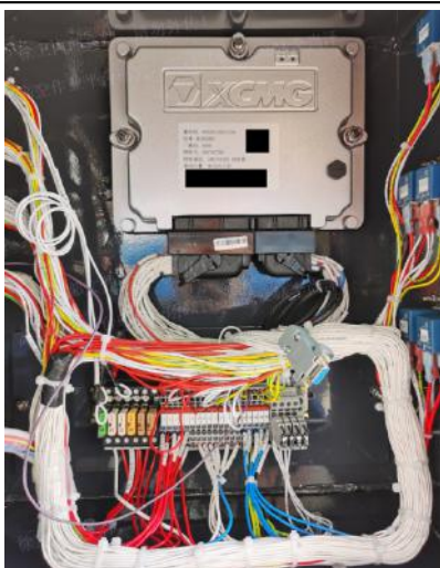
Afb. 5-10 Componenten in de schakelkast
